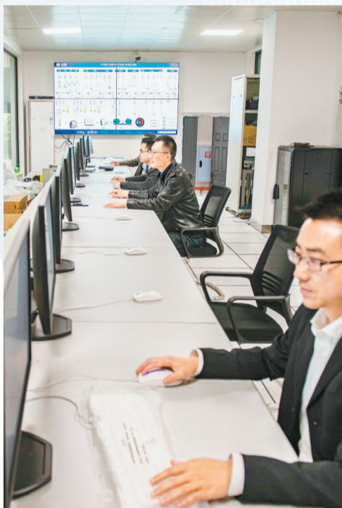
4月7日，即将投入使用的煤矿高压供用电系统安全准入分析验证实验室正在进行最后调试。 本组图片均由记者 崔力摄/视觉重庆
